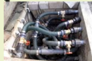
Pumpenschächte werden gern zu klein gebaut. Dieser ist 1 x 1 m groß, enthält 2 Pumpen und eine Verteilung auf mehrere Quellen.
