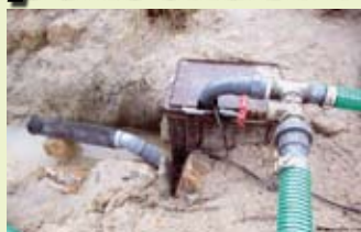
Am Ende des Filtergrabens steht der Pumpenschacht. In diesem Fall wird durch den gebogenen Druckstutzen das Wasser auf zwei Quellen/Filter verteilt.
